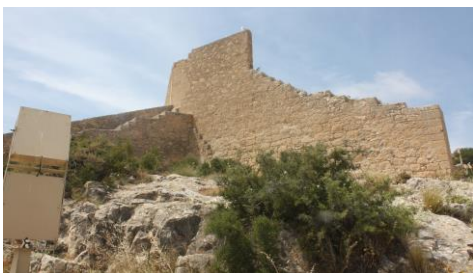
Fig 5. Discontinuidad recorrido muralla. (Santiago José Sánchez Orts)
